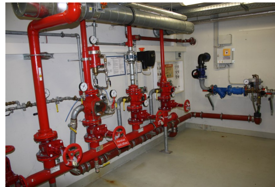
Sprinklerzentrale mit mehreren Alarmventilstationen
